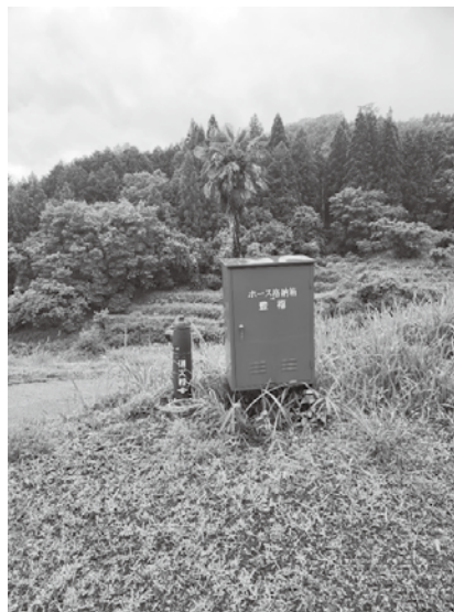
▲消火栓とホース格納箱
