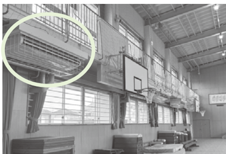
▲姫路市安室小学校体育館空調設備
