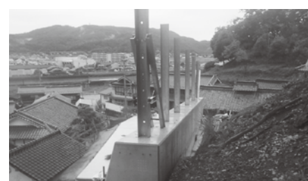
▲急傾斜地崩壊対策事業（大願寺）
