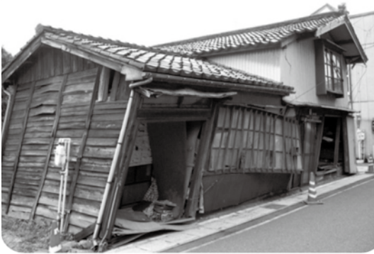
▲危険空き家 (出典：消防防災科学センター)
