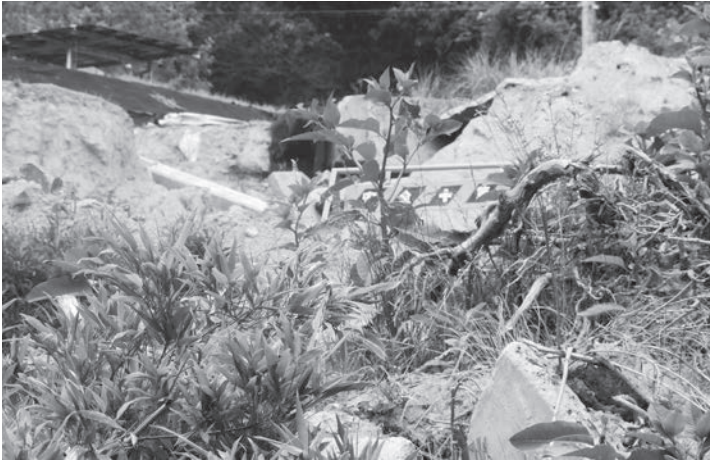
▲末包太陽光発電所崩壊現場
