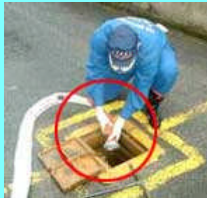
(地下式消火栓)
