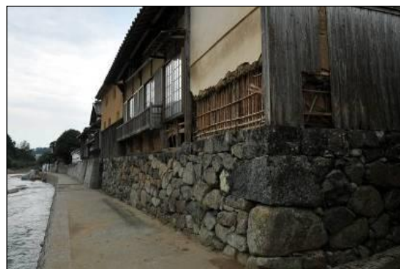
平福景観形成地区の被害状況
