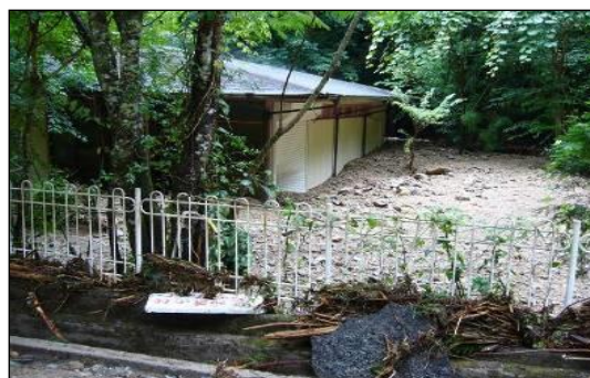
佐用町昆虫館の被害状況
