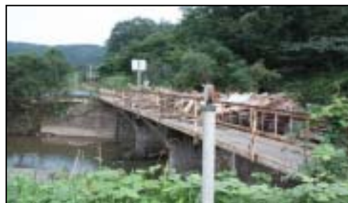
姫新線の被害状況【佐用町須安】
