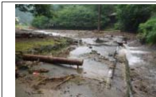
道路の被害状況【佐用町水根】
