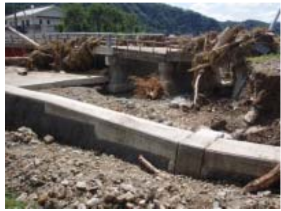
橋梁の被害状況【佐用町横坂】
