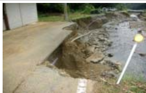
道路の被害状況【佐用町須安】
