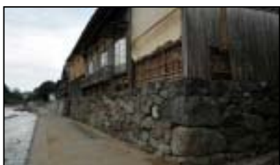
平福景観形成地区の被害状況
