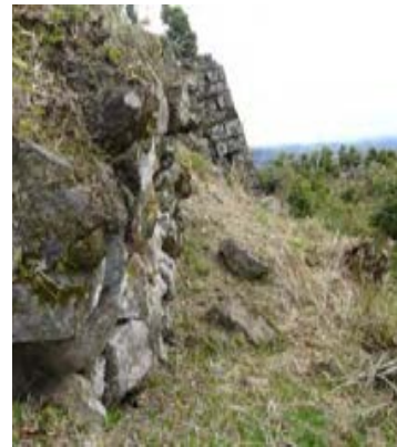
写 6-8 ク. 二の丸東区西側石垣崩落部
