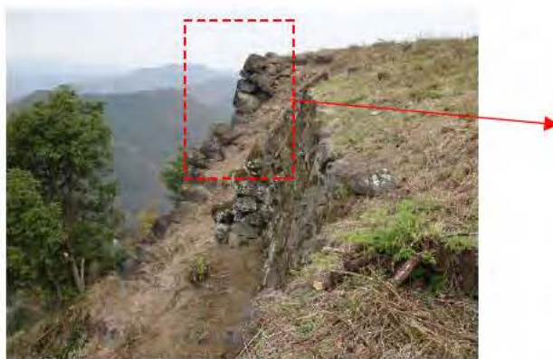
写 6-15 ソ. 二の丸西区 隅角部の崩落
