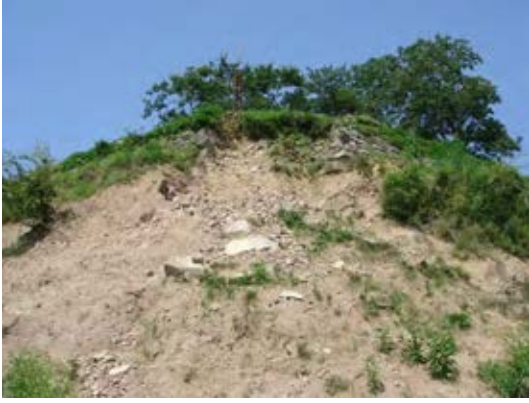
写 6-1 ア. 天守南西隅角部 石垣崩落部
