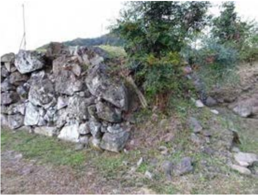
写 6-19 テ. 大手榊形虎口隅角部崩落
