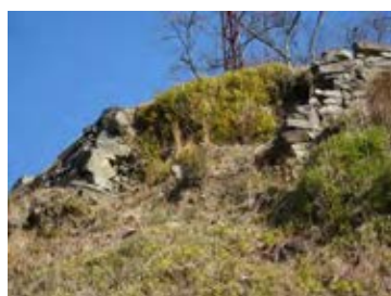
写 3-20 天守丸西 崩落部
