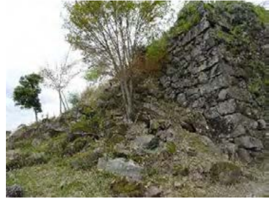
写 6-4 エ. 本丸南東部 石垣崩落部
