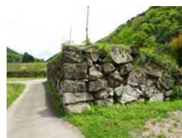
写 3-22 御殿屋敷跡大手櫓形虎口石垣変状
