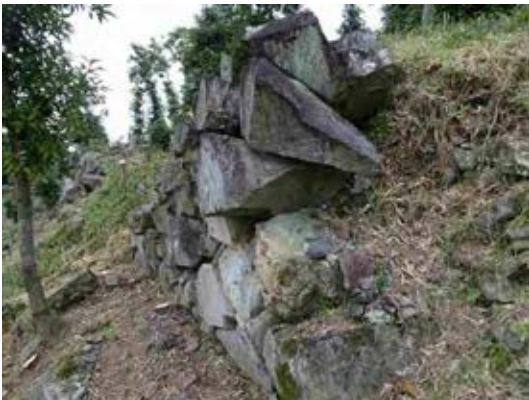
写 6-7 キ. 馬場西側端部崩落
