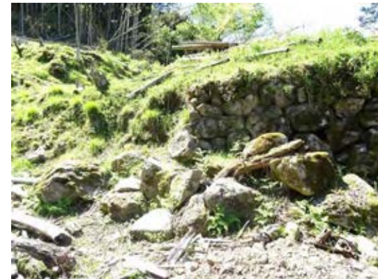
写 6-24 ネ. 山側石垣端部崩落
