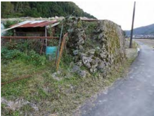
写 6-21 ナ. 南石塁農道側分断箇所の変状
