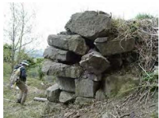
写 6-6 カ. 二の丸東区 隅角部の変状
