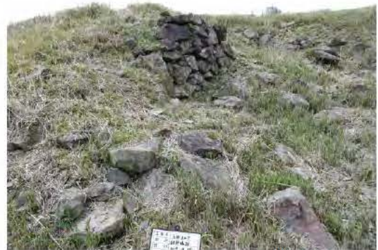
写 6-12 シ. 三の丸南虎口石垣端部崩落
