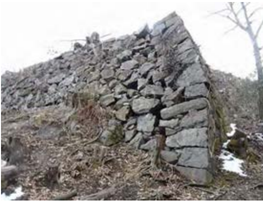
写 6-5 オ. 二の丸東区 隅角部孕み出し
