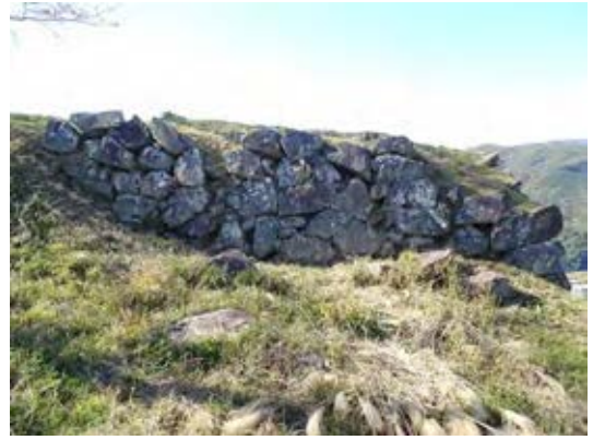
写 6-2 イ. 天守虎口西側石垣と崩落石
