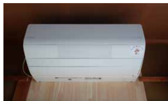
新たに設置した土井自治会のエアコン
