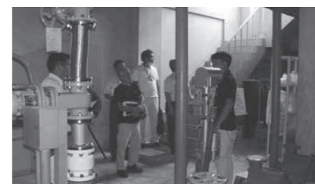
▲久崎上水道施設のポンプ室
