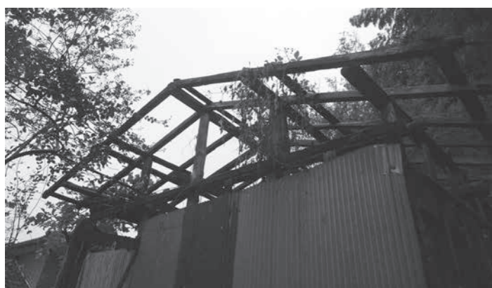
▲屋根がなくなった建物 空き家対策は重要課題
