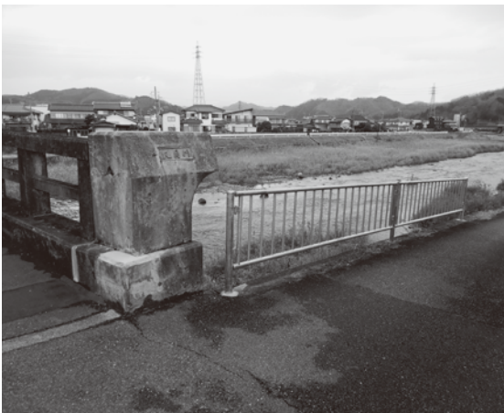
▲ 防護柵の延長が必要
