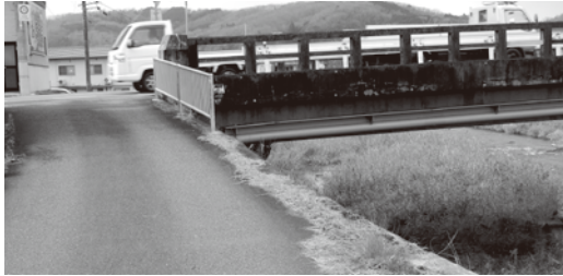
▲ 新佐用大橋上流側 道幅が狭く非常に危険
