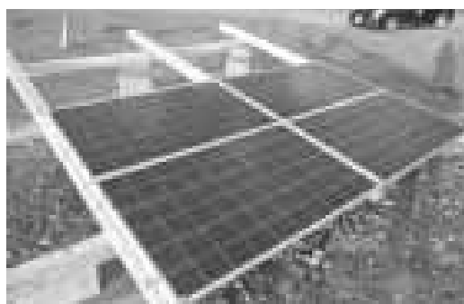
▲太陽光発電木製架台（長谷申山残土処分地）
