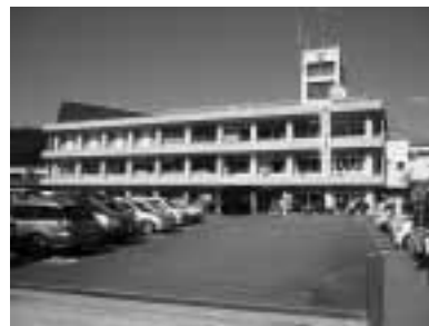
▲老朽化した役場本庁舎
