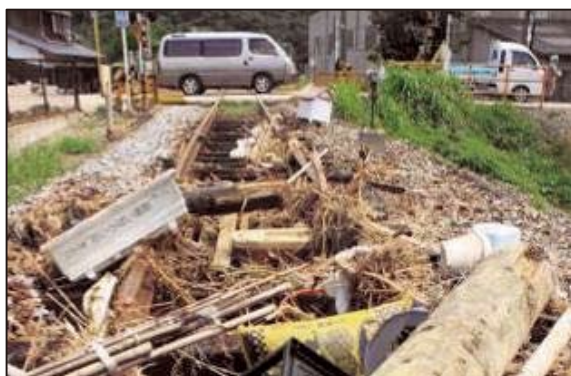
姫新線の被害【上月】
