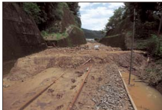
智頭急行線の被害【平福】
