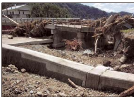
橋梁の被害【横坂】
